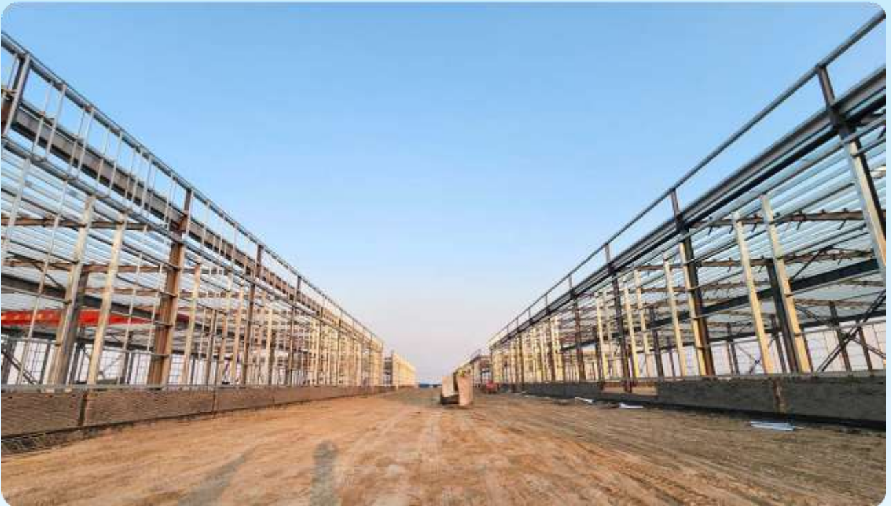
■ 鑫海化工集团新材料库房项目 / Xinhai Chemical Group New Material Warehouse Project
