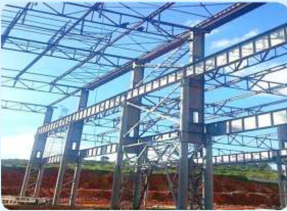
■ 河南机械锻造钢结构建设项目 Henan Machinery Forging Steel Structure Construction Project
