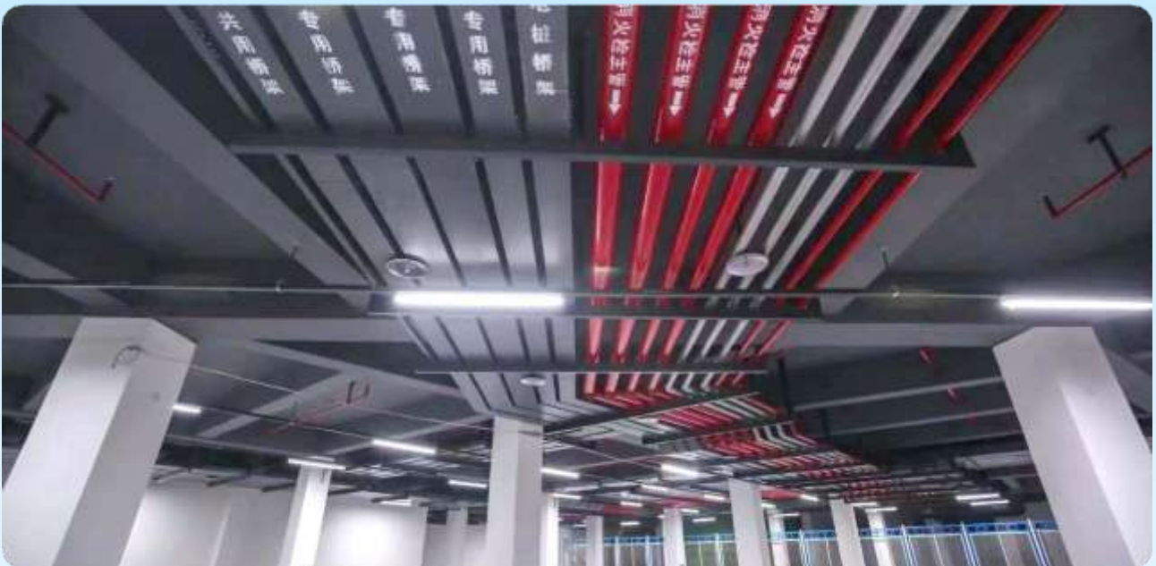
■ 世易尚城地下车库消防项目 / Shiyishangcheng Underground Garage Fire Protection Project
