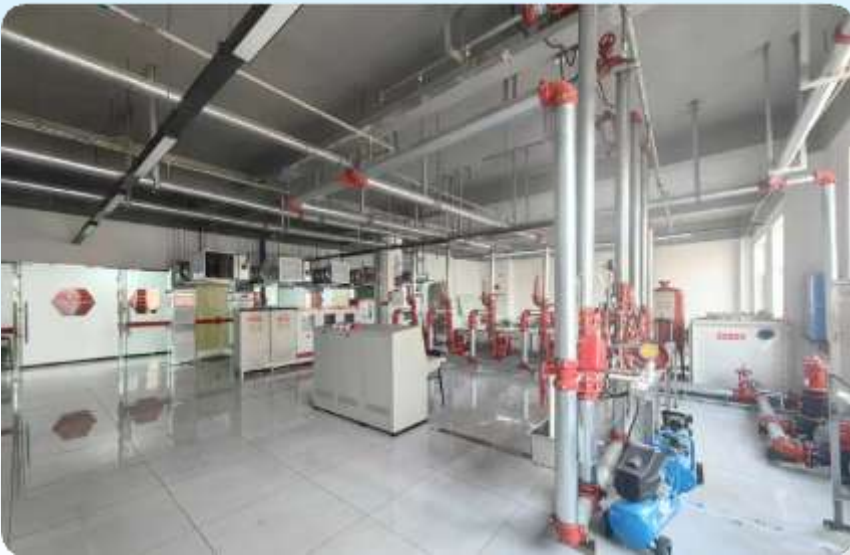
■ 阳光花城消防控制室安装项目 / Sunshine Flower City Fire Control Room Installation Project
