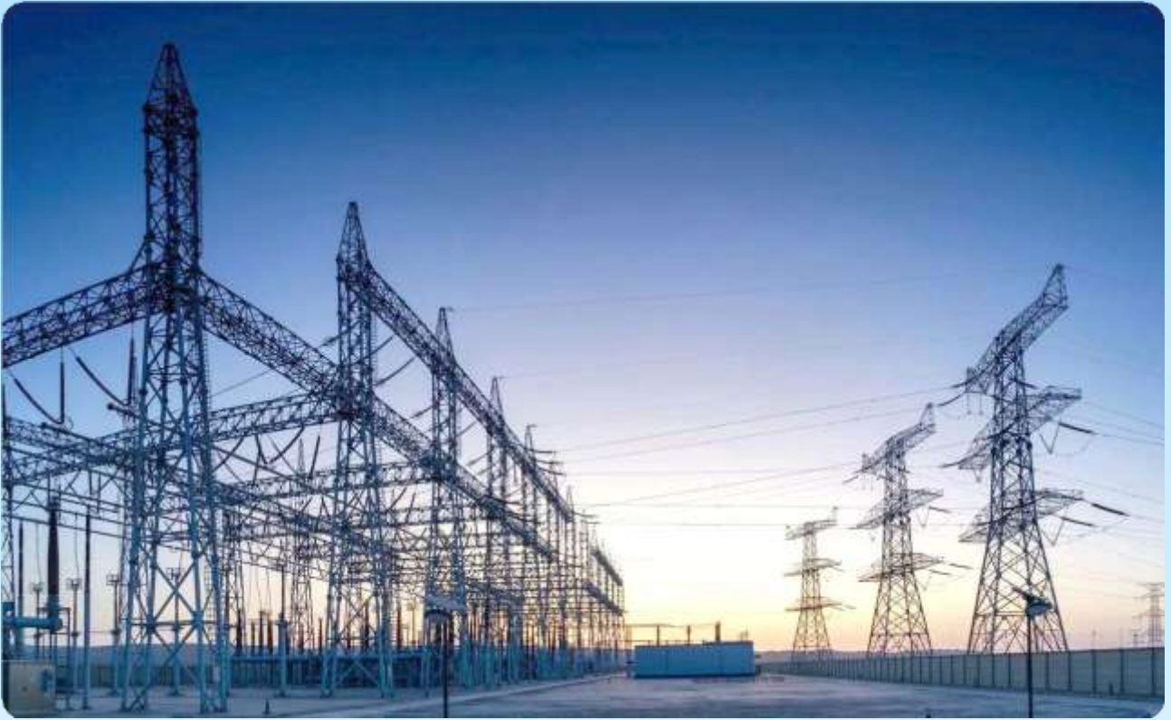
■ 110kV变电站工程项目 / 110kV Substation Engineering Project
